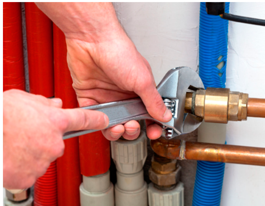
Drukschommelingen treden op in iedere leidingwaterinstallatie.
